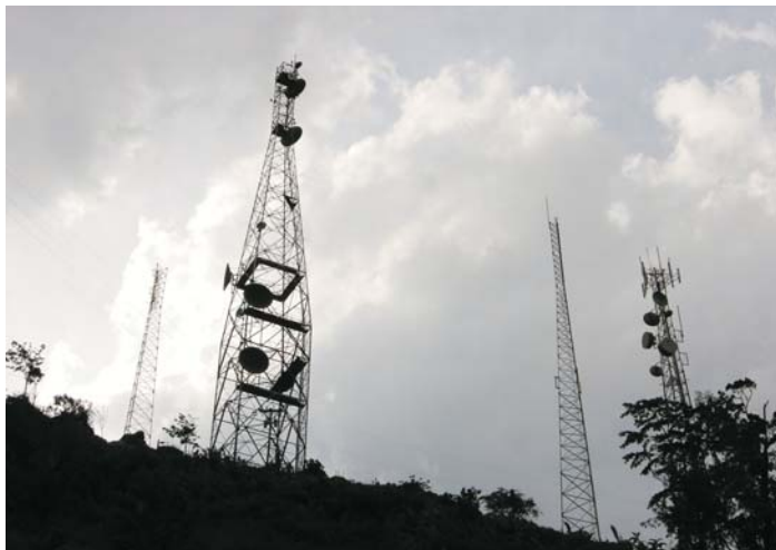
Antenas de telecomunicaciones.
